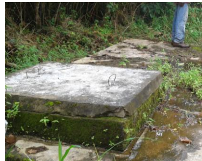
Photo 5: Une installation de captage d'eau à Bakassa
