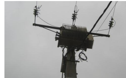
Photo 8: Un transformateur à Toula
